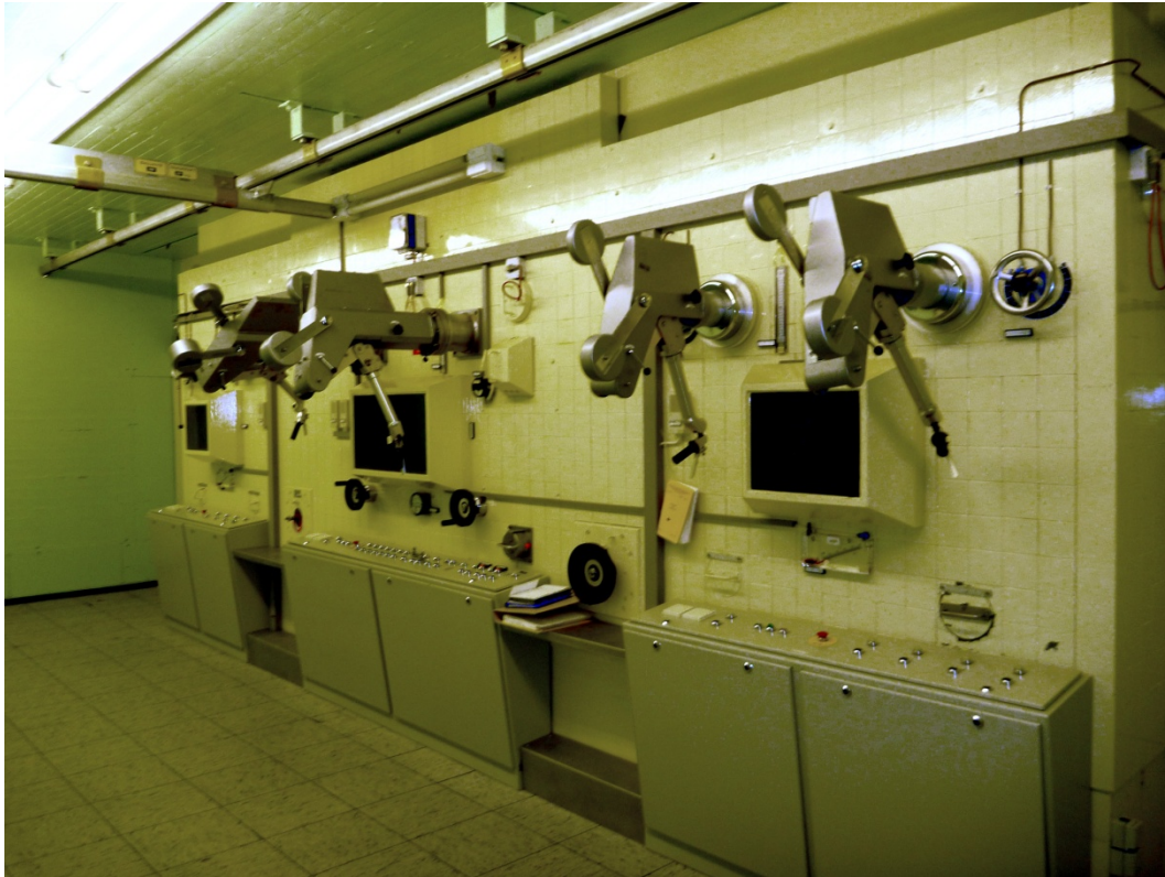
Abbildung 4-16: Dosimetriezellen mit Manipulatoren und Bleiglasfenstern
