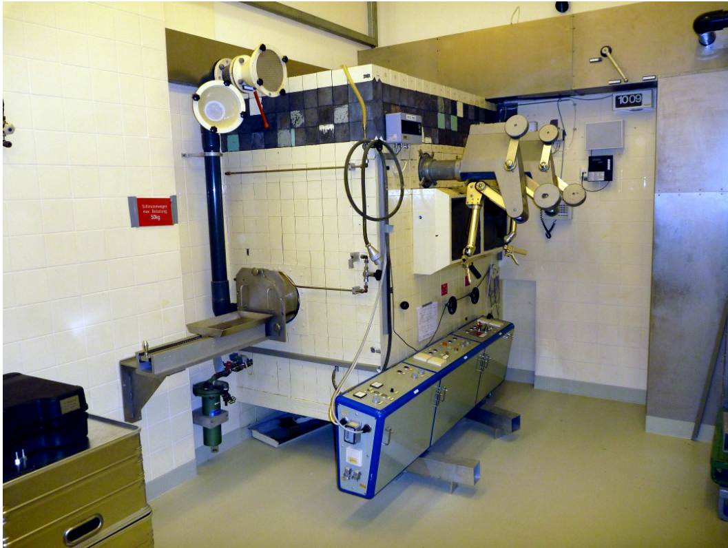
Abbildung 4-15: Bleizelle 1 mit Manipulatoren und Bleiglasfenstern
